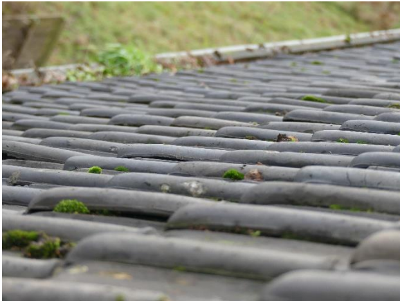
Ongelijk liggende pannen
