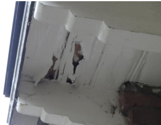
Schade onderzijde luifel
