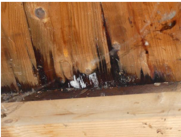
Plaatselijk nat dakbeschot
