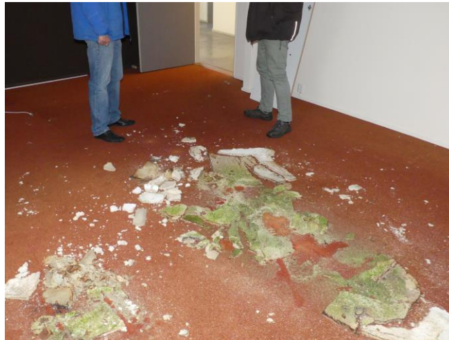
Systeemplafond platen op vloer t.g.v. waterschade
