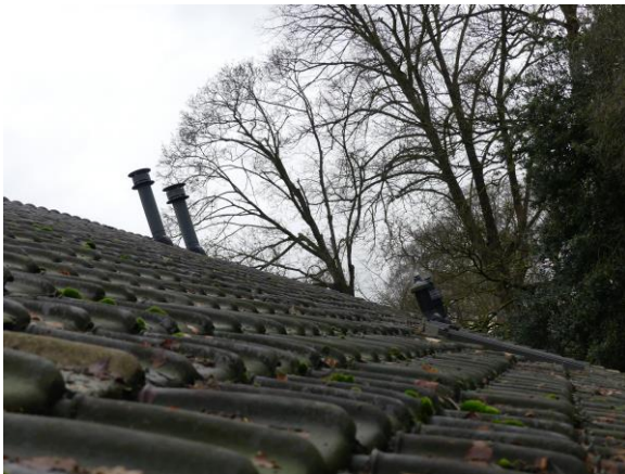
Pannen dak licht vervuild
